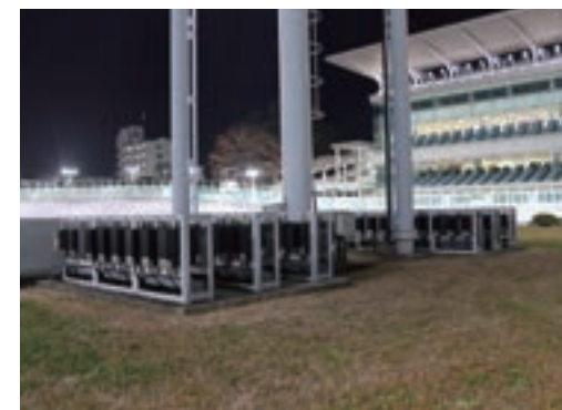
センターボール下の電源ユニット
