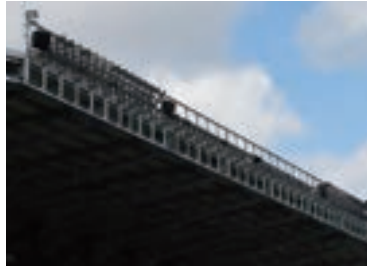
メインスタンド屋根の LED 照明
