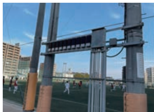
電源 BOX を地上に設置することにより メンテナンス性が向上
